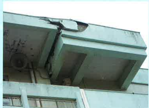
校舎の各所で崩落が発生した（照沼小）
