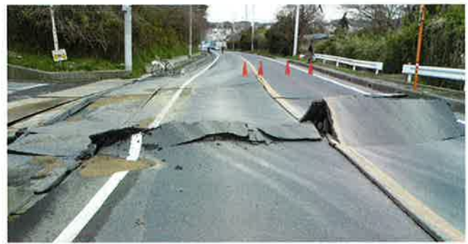
波打つ道路（平原工業団地付近）
