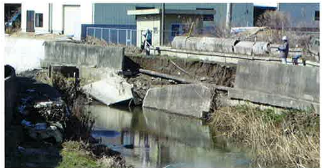
崩壊した護岸（宿地内）
